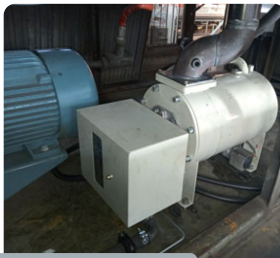
Kesselbaugruppe der AST Vorwärmanlage K35-50
